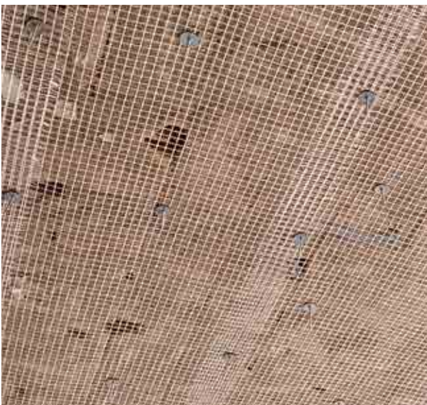
Sistema SAFENET installato
