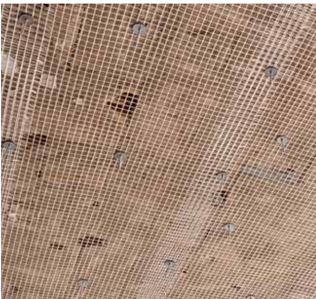
Sistema SAFENET installato
