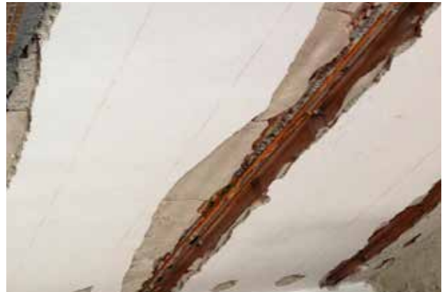
La prima fase di intervento prevede la rimozione delle parti incoerenti del travetto in calcestruzzo, pulizia e passivazione dei ferri di armatura.
