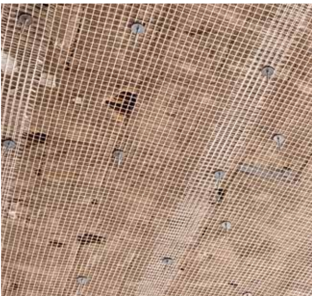
Sistema SAFENET installato
